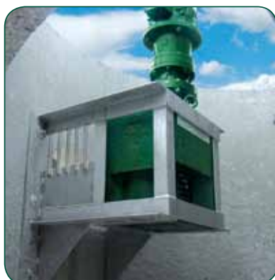
Mini Monster установленный в насосной станции
